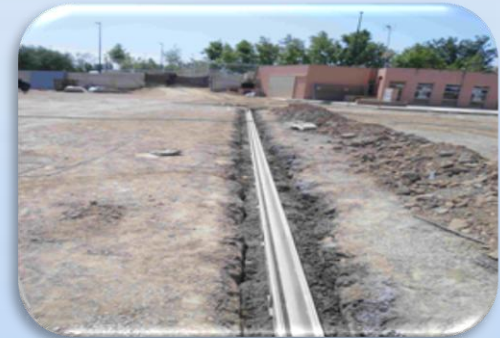
Canales de Drenaje
