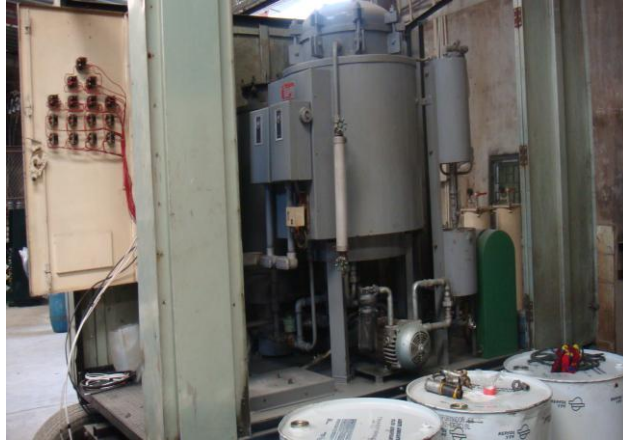
FIGURA 3.3 EQUIPO FILTRADOR DE ACEITE PARA LOS TRANSFORMADORES
