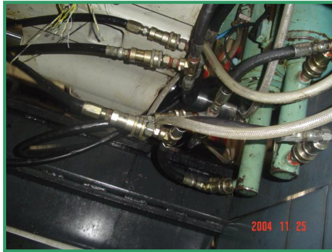
GRÁFICO 4.5 : MANGUERAS HIDRÁULICAS DE LOS MOLDES
