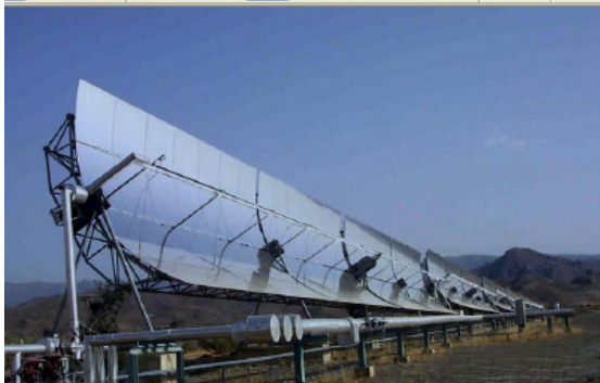
Figura 16. Colector solar de media concentración instalado en la plataforma de Almería
