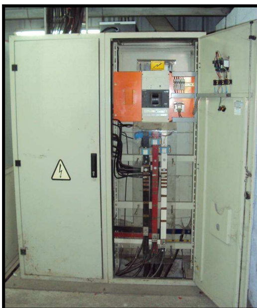
Fig. 9 Disyuntor principal de 1000Amp
