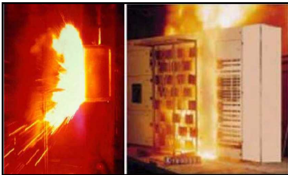
Fig. 1 Ejemplo de arco eléctrico en panel de distribución
