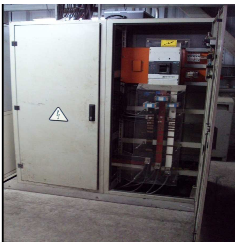
Fig. 4 Tablero de 380V
