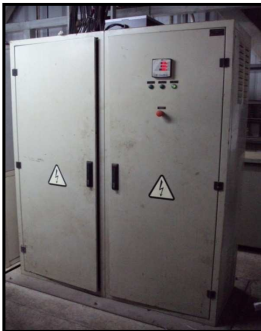
Fig. 8 Tablero de distribución principal de 380 V
