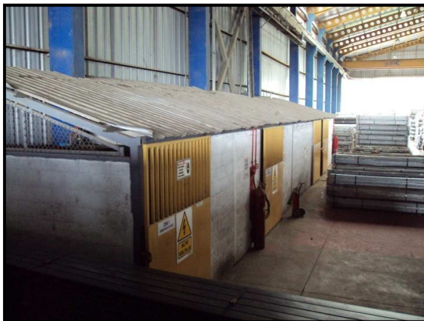
Fig. 3 Cuarto de Distribución de la Planta # 2
