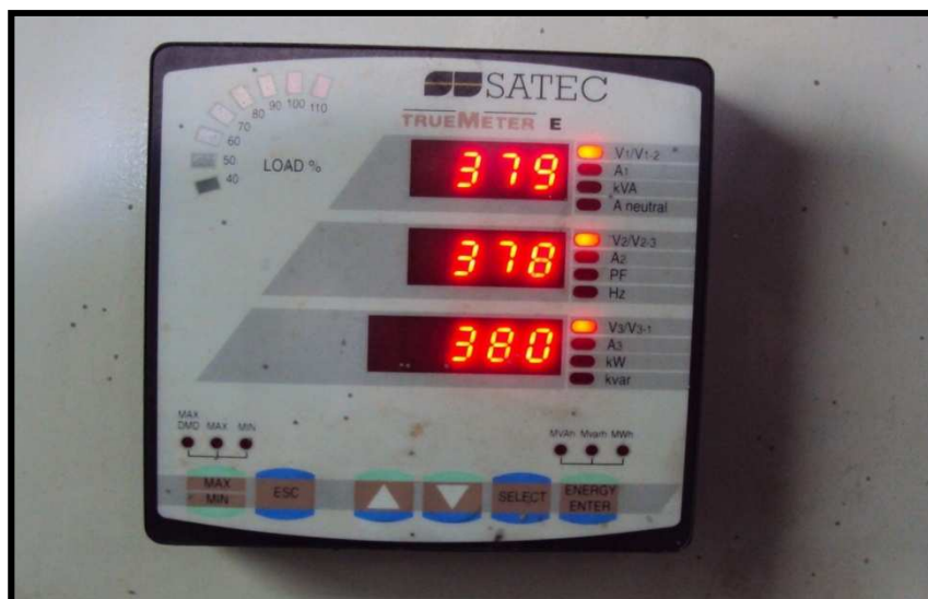
Fig. 11 Valores de voltaje por fase del Tablero de distribución de 380v
