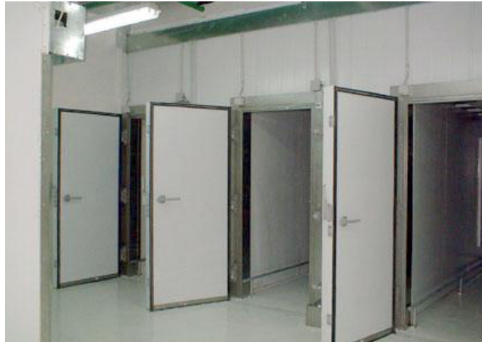
FIGURA 2.4 PUERTAS DE CÁMARAS.
