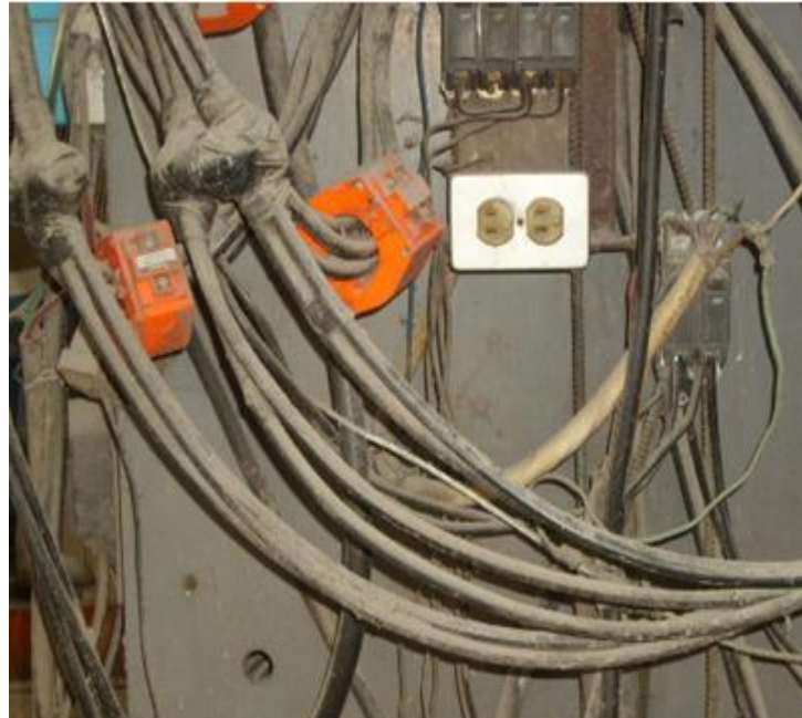
Fig. 6: Instalaciones mal diseñadas [8]
