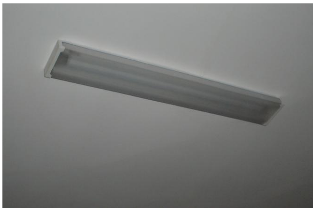
FIGURA 3.2 ILUMINACIÓN CON CUBIERTAS PROTECTORAS
