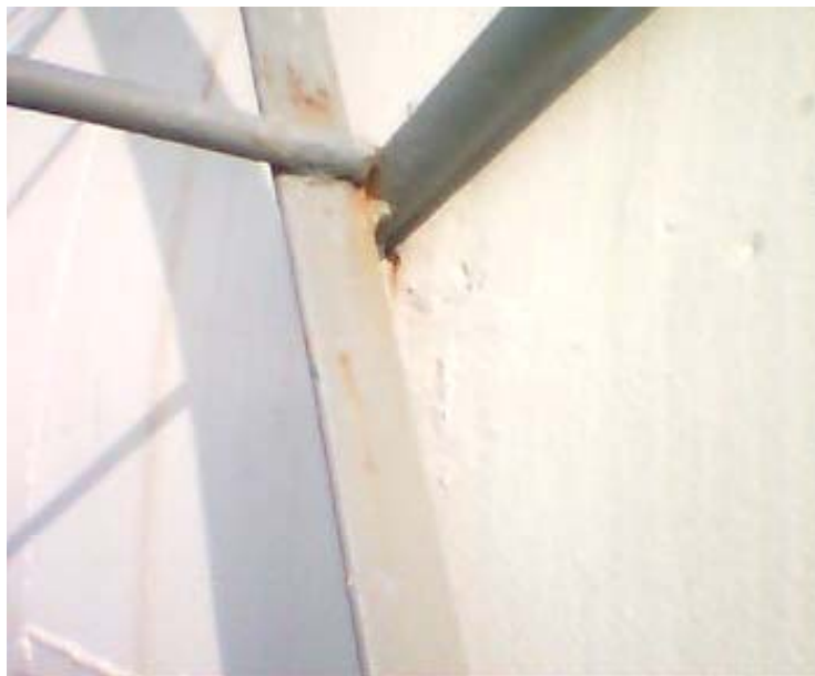
FIGURA 3-7. CORROSIÓN ENTRE ESCALERA Y TANQUE- TK 8
