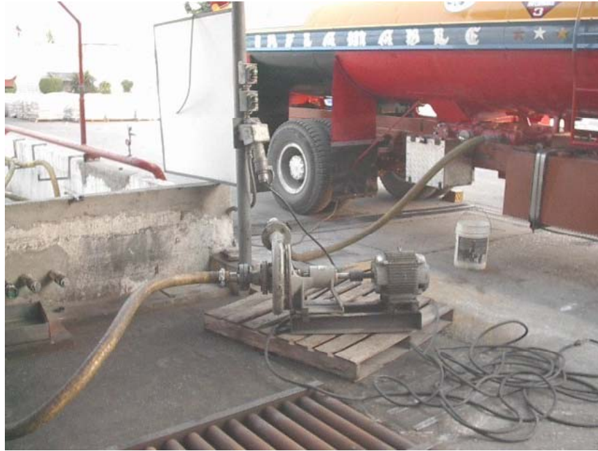
FIGURA 3-2. FALTA DE SEGURIDAD EN LA DESCARGA DE PRODUCTO
