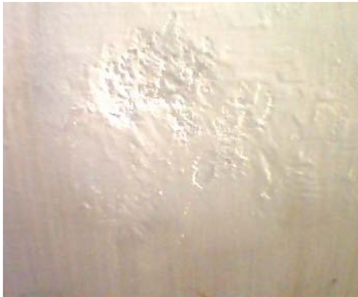
FIGURA 3-6. DISMINUCIÓN DE ESPESOR LOCALIZADA- TK 7
