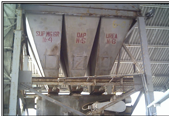
TOLVAS DE ALMACENAMIENTO
