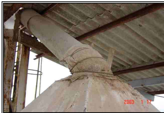
DUCTO PRINCIPAL. VISTA INFERIOR
