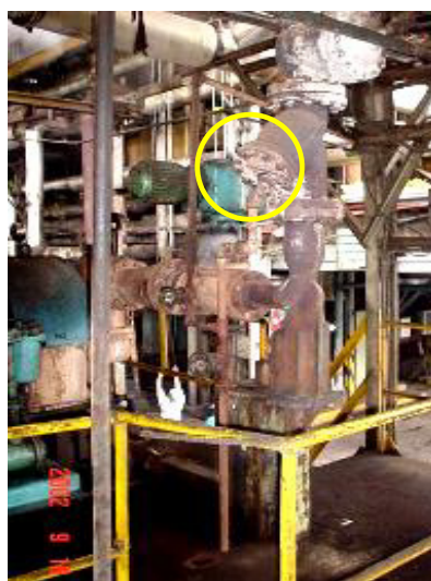
FIGURA 6.13 PURGA MANUAL INSTALADA EN UN FILTRO
