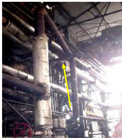
FIGURA 8.9 LÍNEA DE DESCARGA MOLINO # 2.SIN AISLAR
