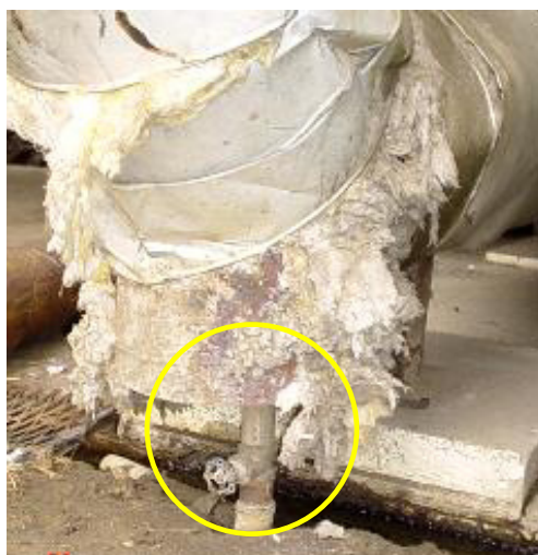
FIGURA 6.19 LÍNEA PRINCIPAL DE DESCARGA TUBERÍA \phi 20''
