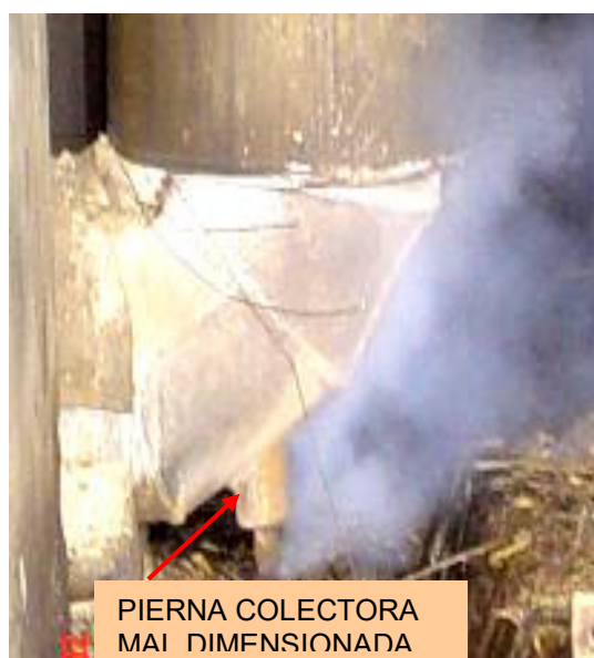
FIGURA 6.18 FUGA DE VAPOR EN LÍNEA DE DESCARGA TURBINA DESFIBRADOR
