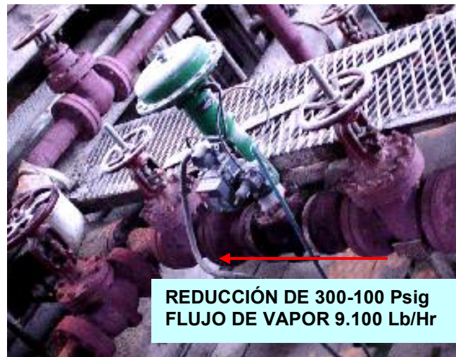
FIGURA 5.5 ESTACIÓN REDUCTORA DE PRESIÓN
