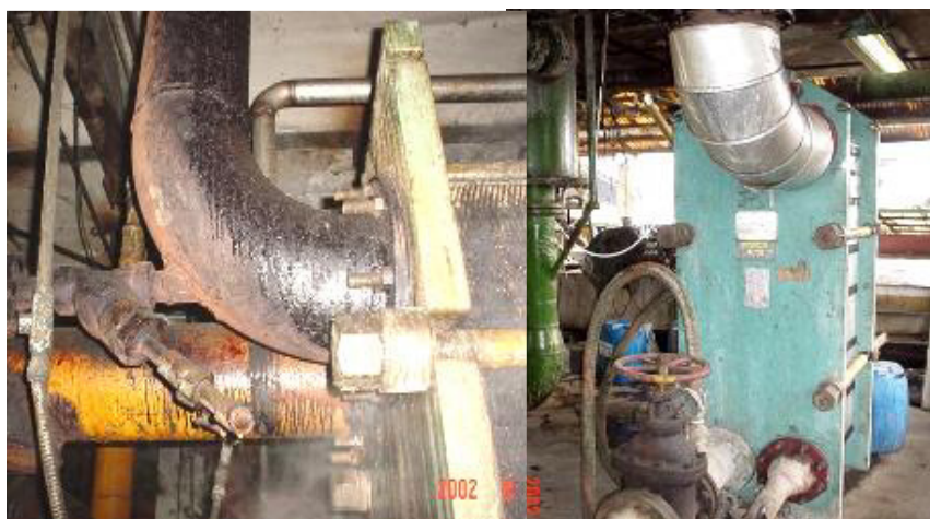
FIGURA 6.28 INTERCAMBIADOR DE PLACAS ALFA-LAVAL
