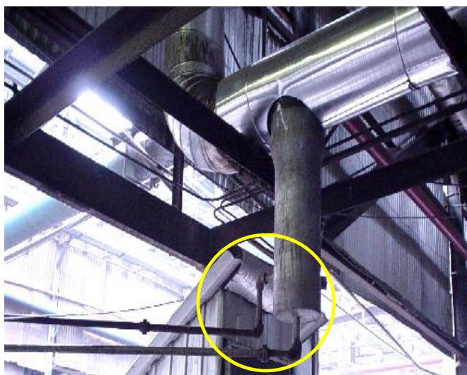
FIGURA 6.3 PRIMERA PIERNA COLECTORA UBICADA ENTRE EL CALDERO D8 Y EL CALDERO C9
