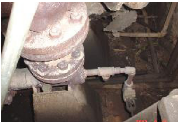
FIGURA 6.14 PURGA MANUAL INSTALADA EN LA PARTE LATERAL DE LA TUBERÍA DE INGRESO A LA TURBINA DEL PRIMER JUEGO DE CUCHILLAS
