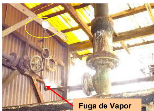
FIGURA 6.29 TORRE DE SULFATACIÓN
