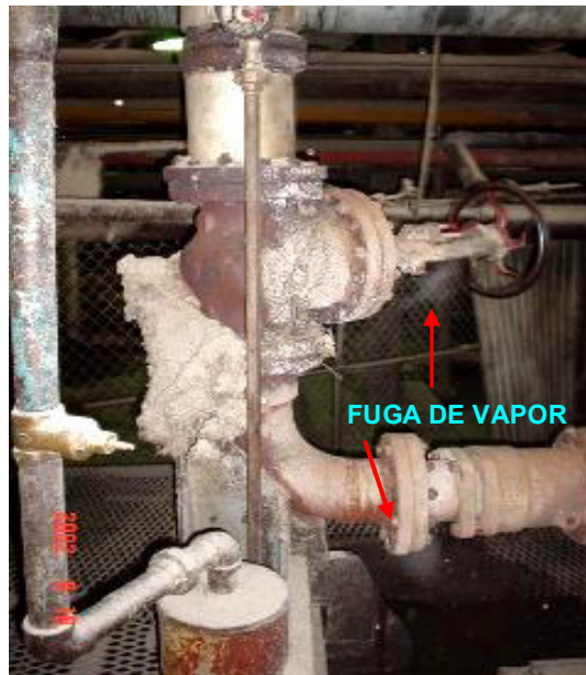
FIGURA 6.9 FUGA DE VAPOR A TRAVÉS DE LOS ACCESORIOS DE INGRESO A LA TURBINA MOLINO # 6
