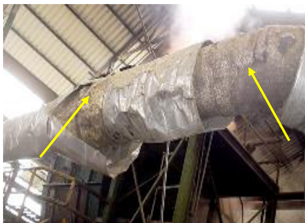
FIGURA 8.6 LÍNEA PRINCIPAL DE ALIMENTACIÓN PARA EL Tandem DE MOLINOS # 2
