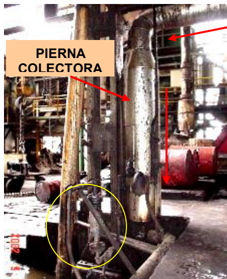
FIGURA 6.11 PIERNA COLECTORA INSTALADA EN FIN DE LÍNEA DE 200PSIG
