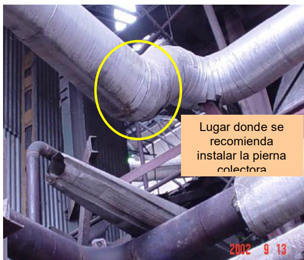
FIGURA 6.2 LÍNEA DE ALIMENTACIÓN TURBOGENERADOR ELÉCTRICO
