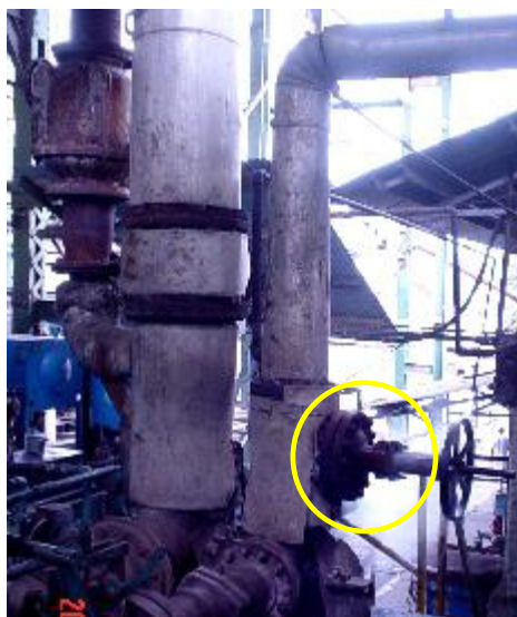
FIGURA 6.17 FUGA DE VAPOR EN PURGA MANUAL ABIERTA TURBINA MOLINO # 4
