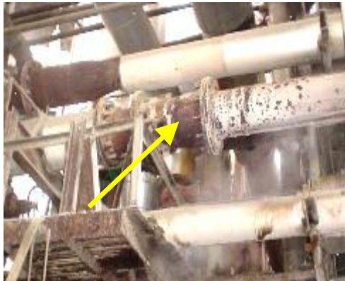
FIGURA 8.8 LÍNEAS DE DISTRIBUCIÓN DE VAPOR PARA EL TANDEM DE MOLINOS # 1 SIN AISLAR
