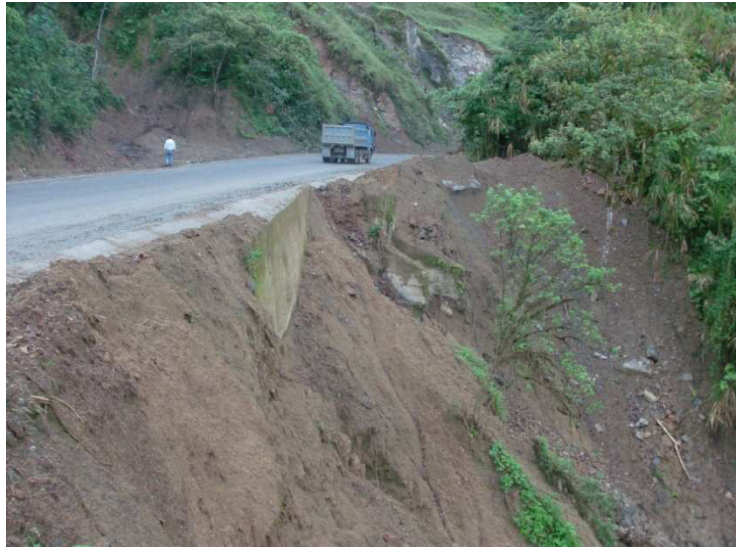
Fig. 1.4 Erosión en carcava del talud inferior de la vía en la salida de la alcantarilla existente, a la izquierda se observa la cañada de tipo torrencial.
