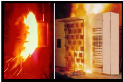
Fig. 1 Ejemplo de arco eléctrico en panel de distribución
