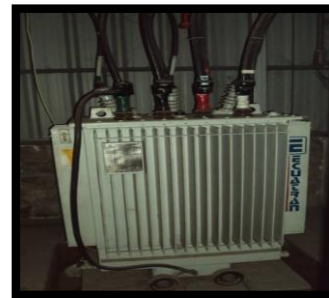
Transformador de 500KVA IPAC S.A.
