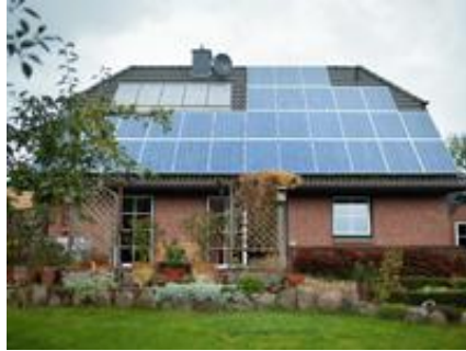
Figura 1. 5 Panel Fotovoltaico Residencial 3
