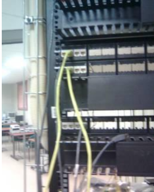
Figura 5.7 Conexión en los puertos del rack
