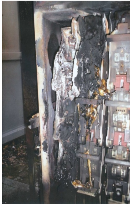
Fig. 2.5. Después de un arco eléctrico.
