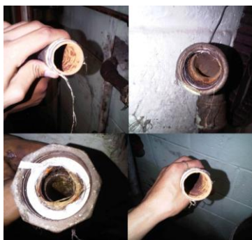
Figura 6. Tubería de Aire comprimido actual en las áreas de Termofijado y Fak
