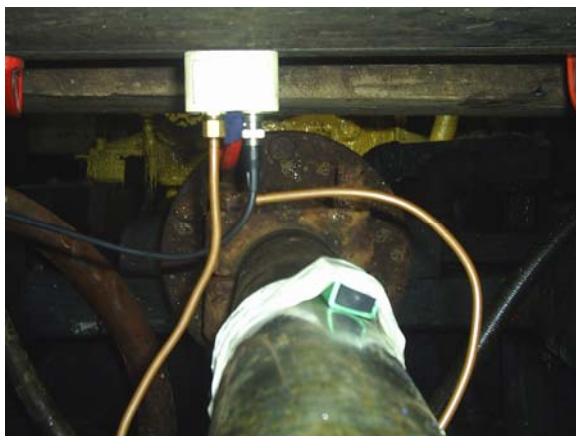
Figura 6. - Dispositivo de medición instalado sobre el eje
