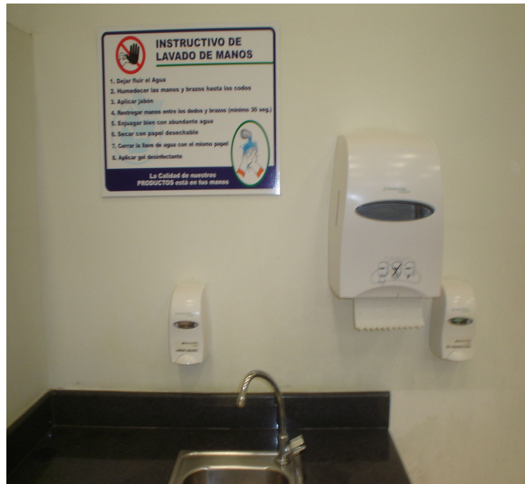
FIGURA 3.3 LAVADERO DE MANOS
