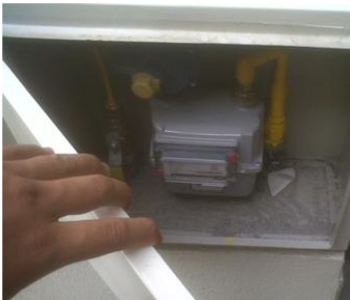
FIGURA 26: CONTADOR DE GLP
