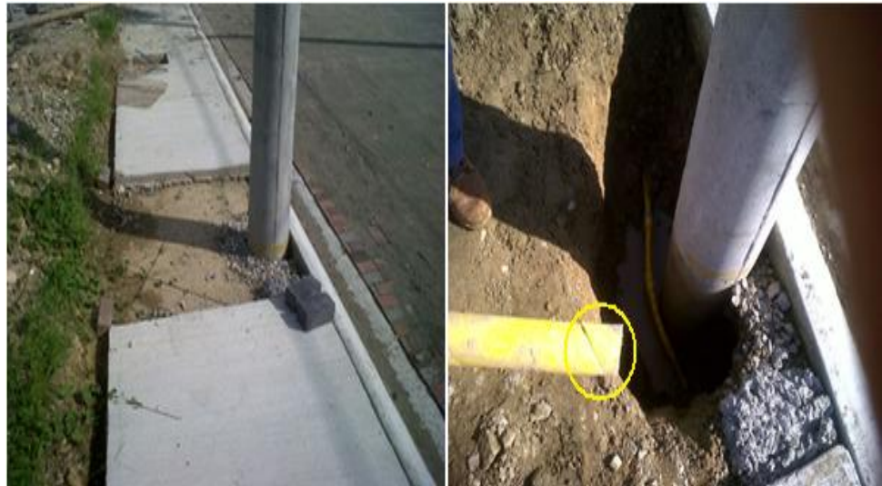
FIGURA 28: PERFORACIÓN DE LA TUBERÍA EN LA INSTALACIÓN DE UN POSTE DE ALUMBRADO PÚBLICO
