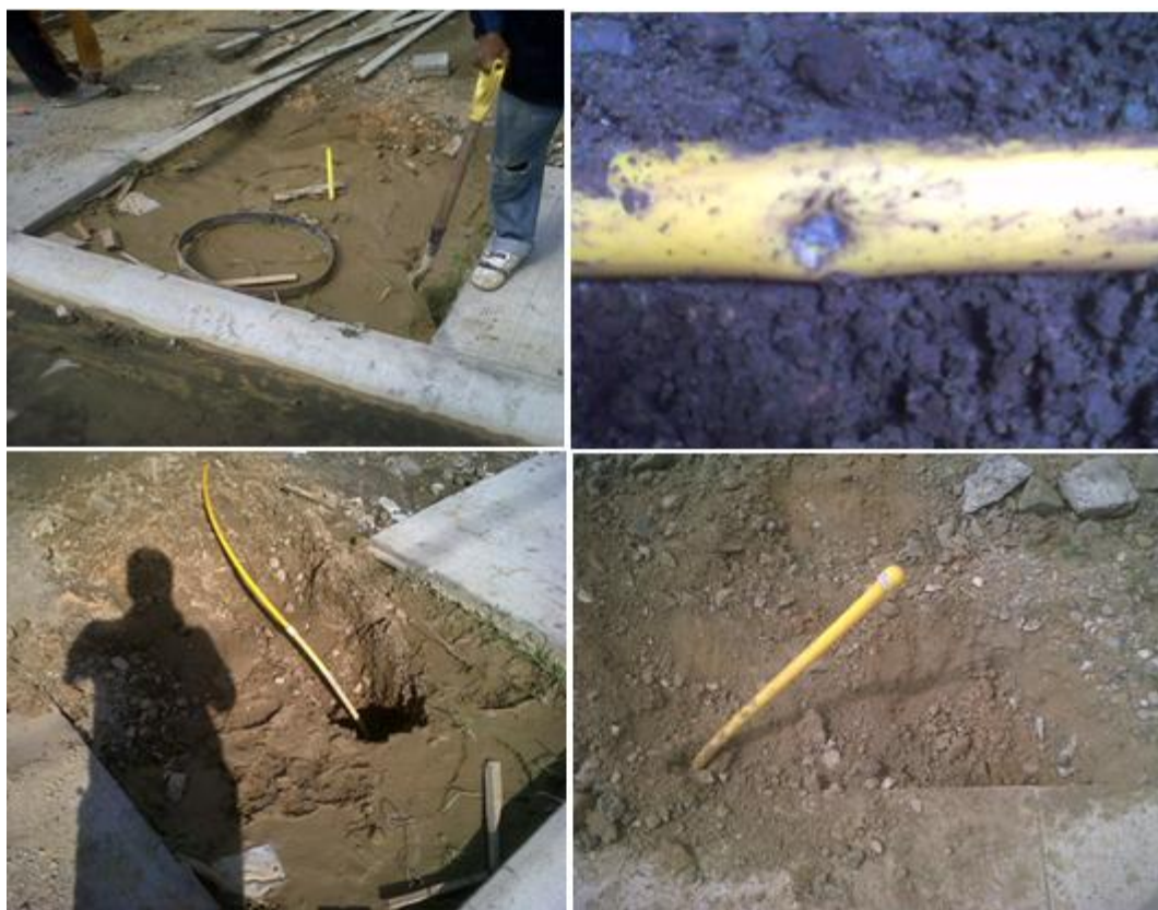
FIGURA 29: DAÑOS Y REPARACIONES EN LA LÍNEA DE POLIETILENO
