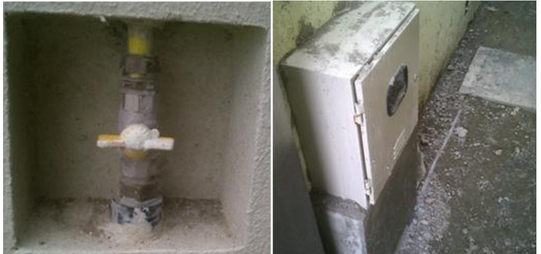
FIGURA 32: DAÑOS EN LOS ACCESORIOS Y CAJAS DE CONTADORES
