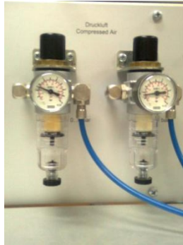
Figura 2.10 Unidad de mantenimiento.
