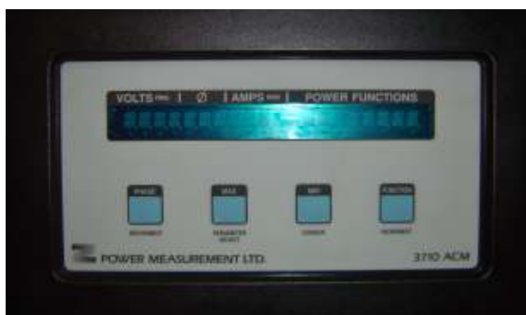
Figura 22. Medidor de Energía Power Measurement 3710.
