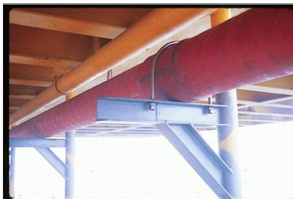
FIGURA 6.1 SOPORTE TUBERÍA SISTEMA CONTRA INCENDIO
