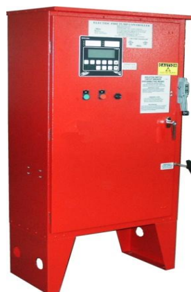
FIGURA 5.5 TABLERO DE CONTROL BOMBA PRINCIPAL CONTRA INCENDIO
