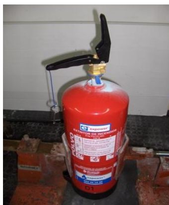
FIGURA 7.4 EXTINTOR CON LA VÁLVULA DESENROSCADA.
