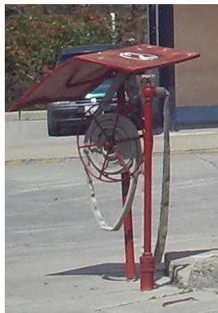
Figura 3.1: Monitor fijo de columna
