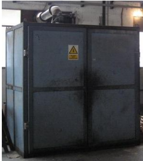
Figura 1.1 Horno industrial de resistencia eléctrica
