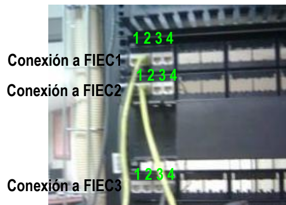
Figura 4.24 Panel de conexión.
