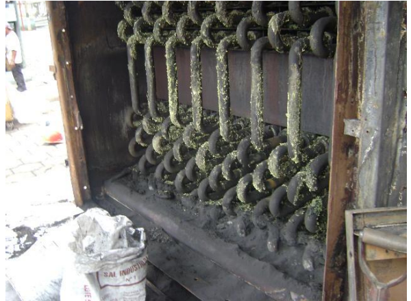
Cenizas y contaminación encontradas en el Economizador
