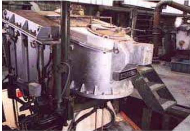
Figura 2.6 Horno de fundición (carga que produce armónicos)
