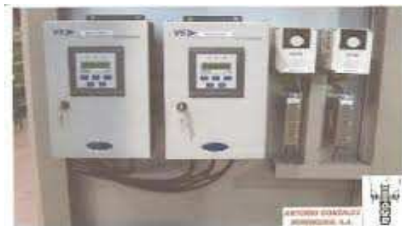
Figura 2.5 Variador estático de velocidad (carga que produce armónicos)
