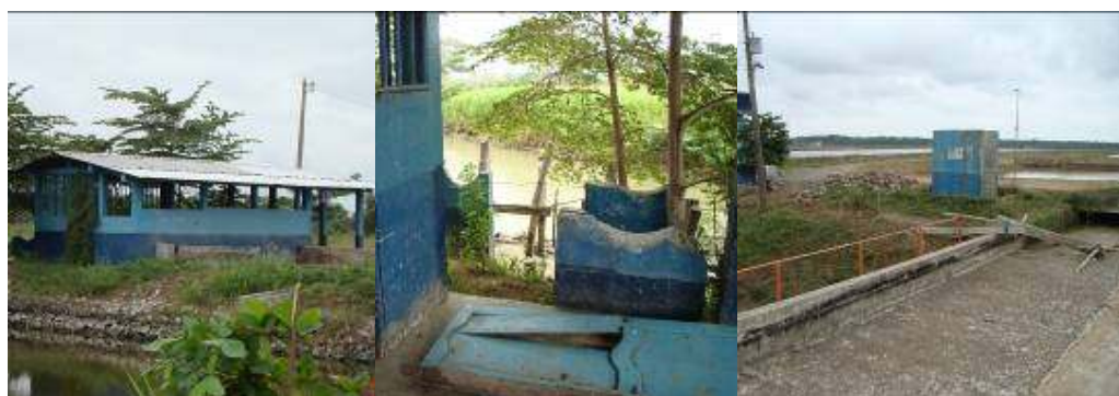
Figura # 31. Estación de bombeo de agua dulce para cultivo de Tilapia (abandonada). Camaronera Domrey (Ex FAFRA). Santa Rosa de Flandes. Fuente: Autores, 2009.
