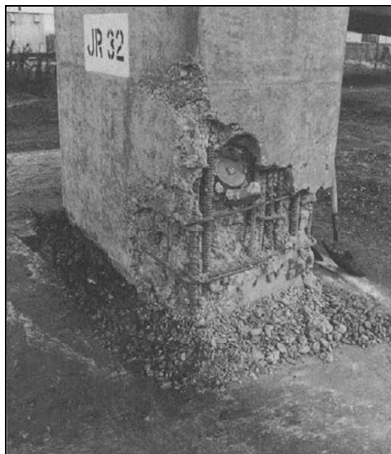
Figura 2.6: Daño en la base de una columna, debido a la falta de longitud de traslape, sismo de Loma Prieta 1989. (Tomado de Priestley, Seible y Calvi, 1996)
