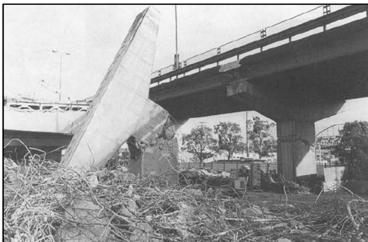
Figura 2.9: Falla por flexión-cortante en la pila del viaducto Route 43/2, debido a la terminación prematura del refuerzo longitudinal, sismo de Kobe 1995. (Tomado de Priestley, Seible y Calvi, 1996)
