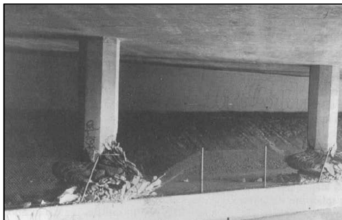
Figura 2.8: Articulaciones plásticas a flexión en columnas de puente Bull Creek Canyon Channel, sismo de Northridge 1994 (Tomado de Priestley, Seible y Calvi, 1996)
