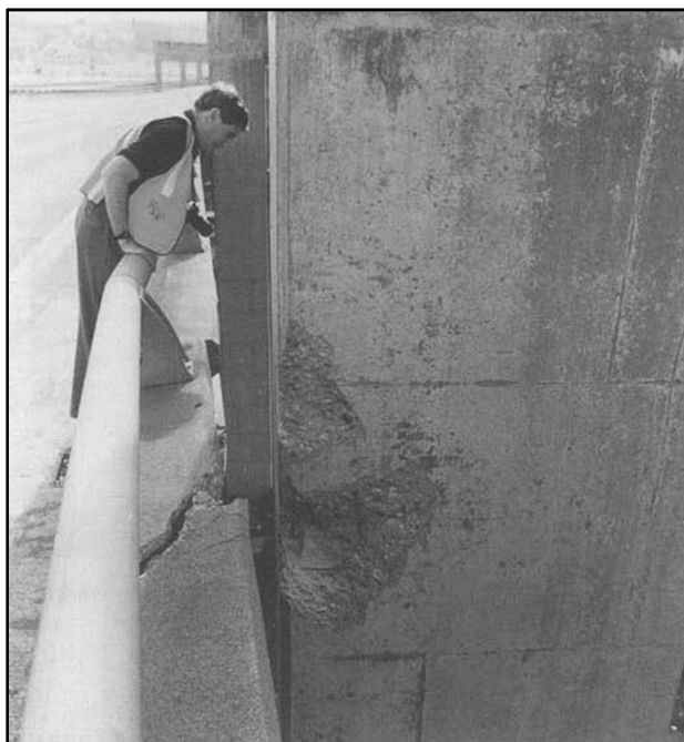
Figura 2.4: Golpeteo del viaducto I-280 China Basin/Southern, Terremoto de Loma Prieta 1989 (Tomado de Priestley, Seible y Calvi, 1996)
