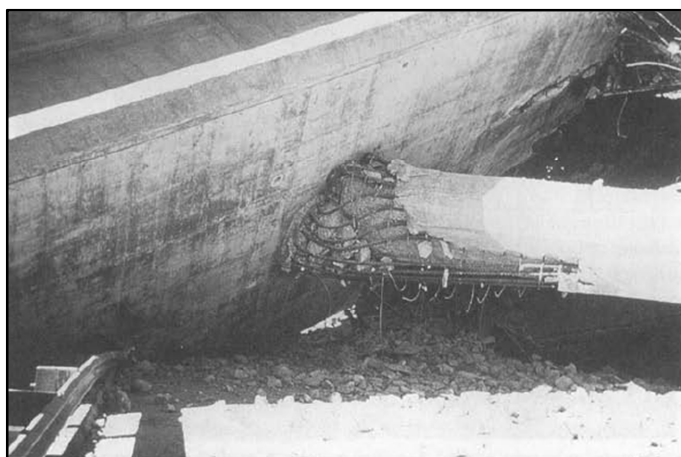
Figura 2.7: Falla en el confinamiento en la parte superior de la columna, sismo de San Fernando 1971 (Tomado de Priestley, Seible y Calvi, 1996)
