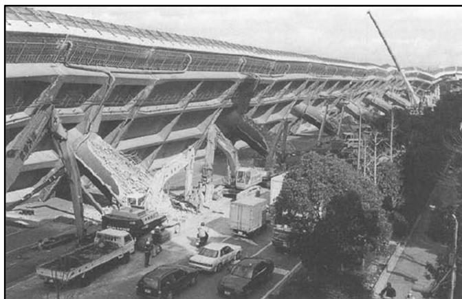
Figura 2.10: Falla por flexión sobre la base de las columnas de la autopista Hanshin, debido a la terminación prematura del refuerzo longitudinal y a un confinamiento inadecuado, sismo de Kobe 1995. (Tomado de Priestley, Seible y Calvi, 1996)
