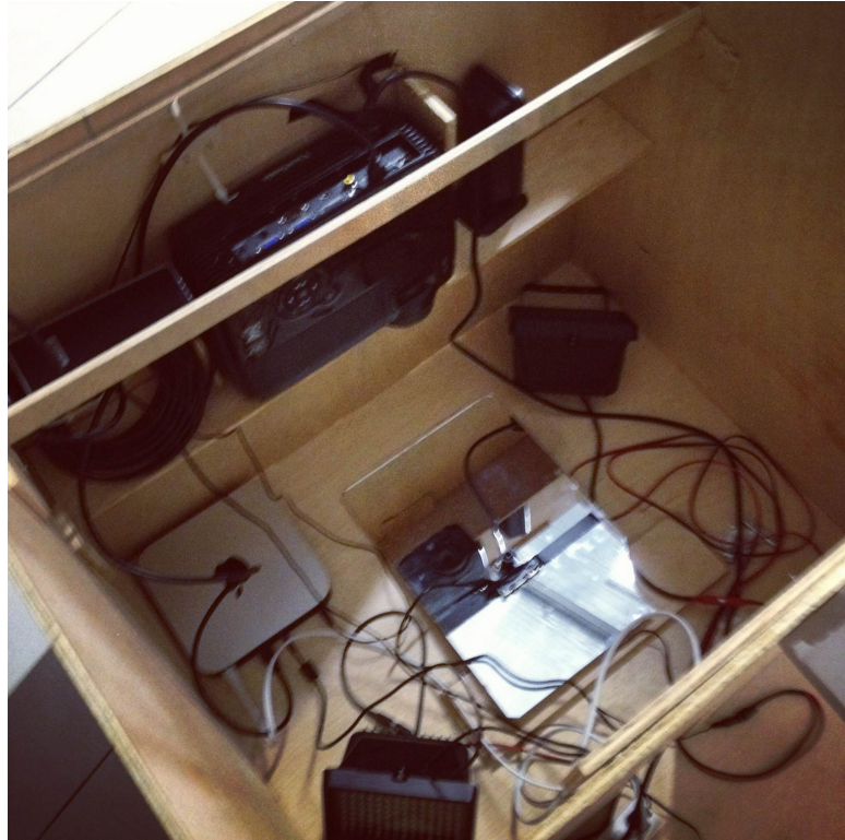
Figura 68: Toma con distribución de elementos en el interior de la caja
