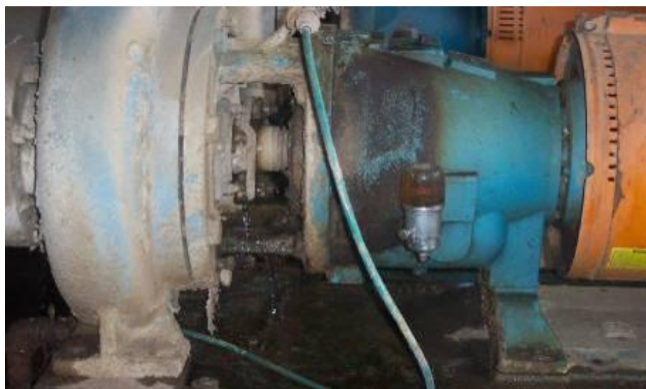
Figura N° 1.16: Bomba limpiadores primarios uniflow, molino 1.
