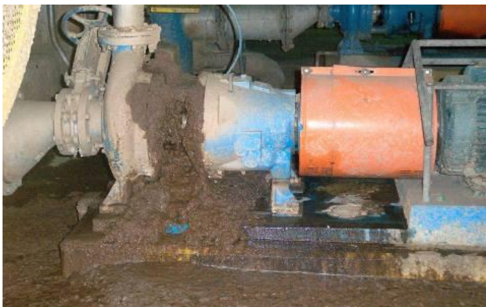
Figura N° 1.12: Bomba tanque de mezcla P14-A, molino 2.
