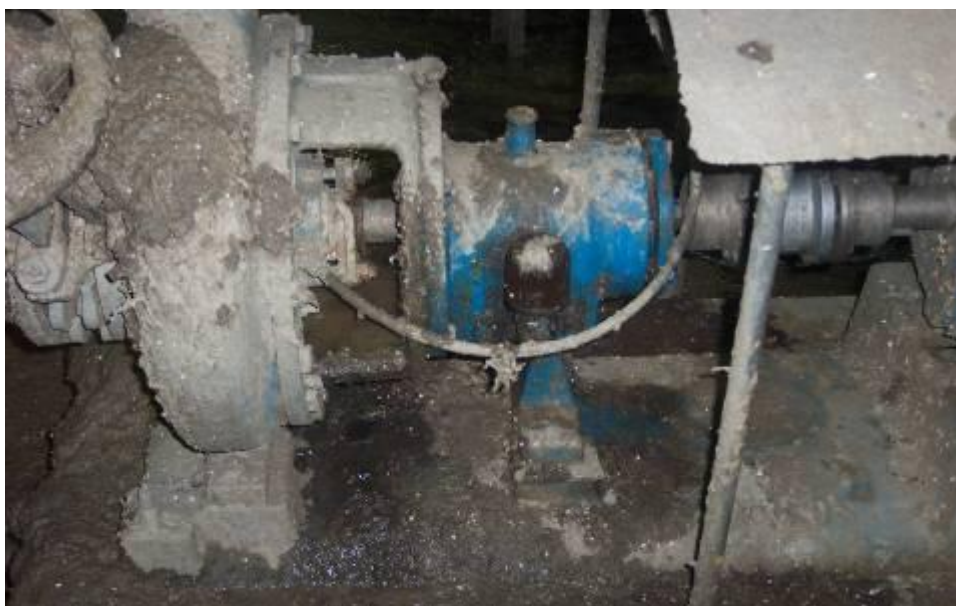
Figura N° 1.11: Bomba limpiadores secundarios uniflow P06, molino 2.
