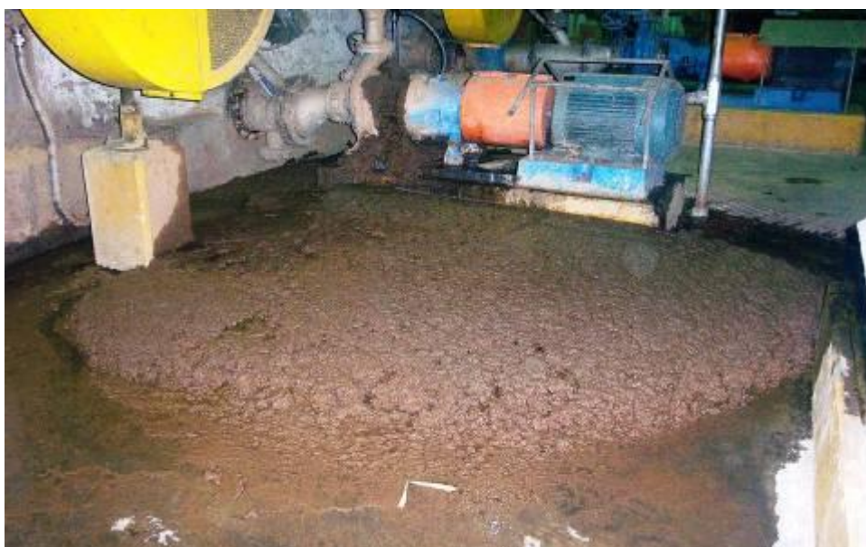
Figura N° 1.13: Bomba tanque de mezcla P14-A, molino 2.
