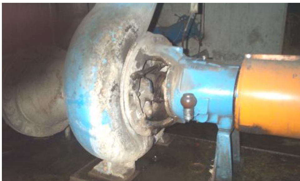
Figura N° 1.10: Bomba limpiadores primarios posiflow P15, molino 2.
