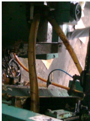
FIGURA 3.11. FUGA DE ACEITE EN MANGUERAS
