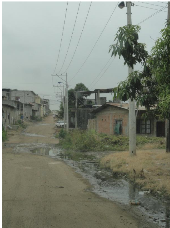
FOTO D.2 Caudal de lluvias corre por la calle 3N frente a la Mzs. 266 y 267
