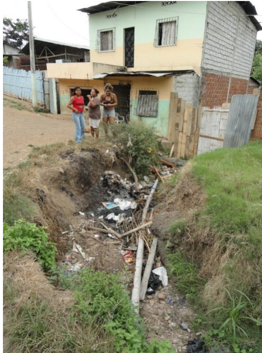
FOTO D.7 Cauce de drenaje cruza entre las Av. 31 y 30 N
