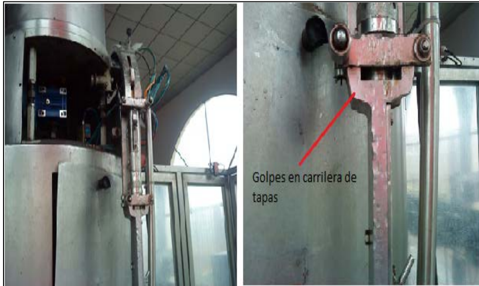
Fig. 14 Deterioro carrilera de tapas
