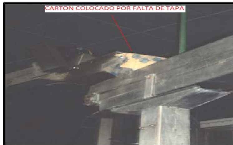
Fig. 13 Deterioro de estructura transporte de tapas
