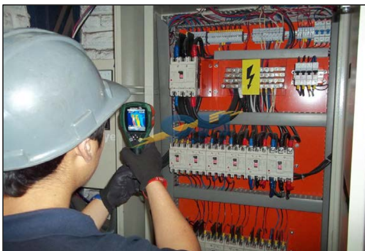
Fig. 23 Análisis termografico de panel eléctrico
