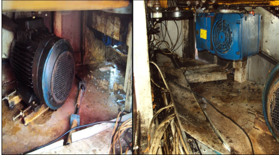
Fig. 4 Parte interna de llenadora con vidrio y cables sueltos
