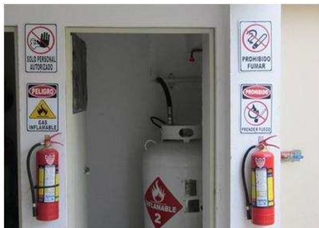
Figura 1.2: Gas centralizado, sistemas contra incendio Fuente: MECHANICAL ENGINEERY S.A.
