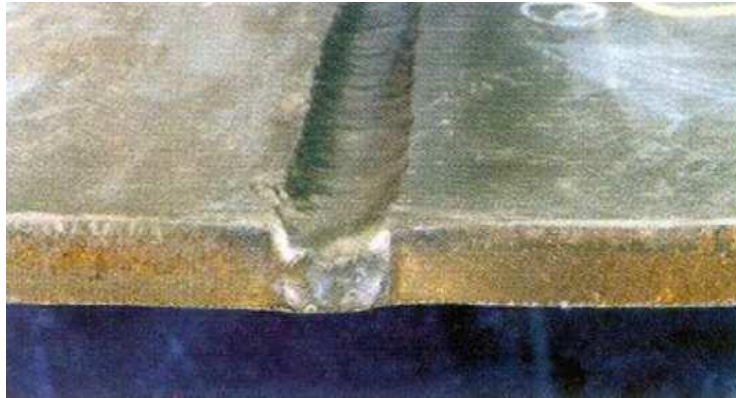
FIGURA 4.14.- SOCAVACIÓN EN CORDÓN DE SOLDADURA DE BISEL
