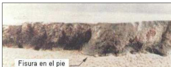
FIGURA 4.6.- FISURA DE PIE
