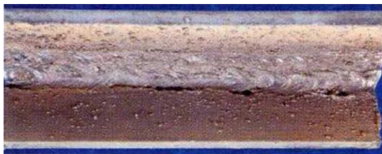
FIGURA 4.13.- SOCAVADURA ADYACENTE A SOLDADURA DE BISEL
