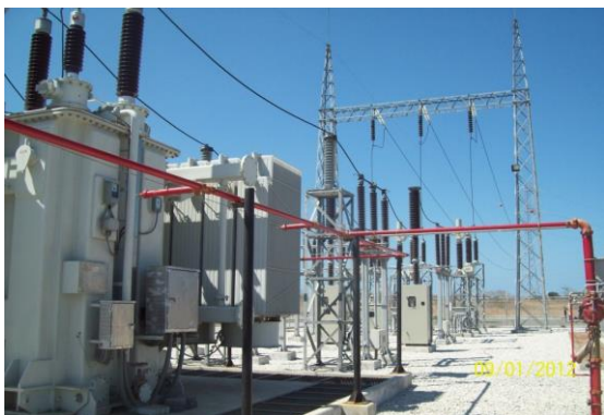
Figura 2.4. Transformador de potencia conectado al S.N.I.
