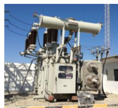
Fig 1 Transformador de Potencia de la S/E Carolina.
