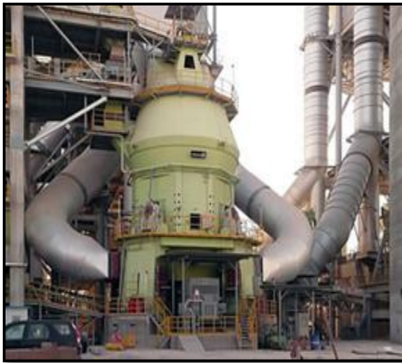
Figura 1.14 Molienda de crudo mediante el Molino Vertical
