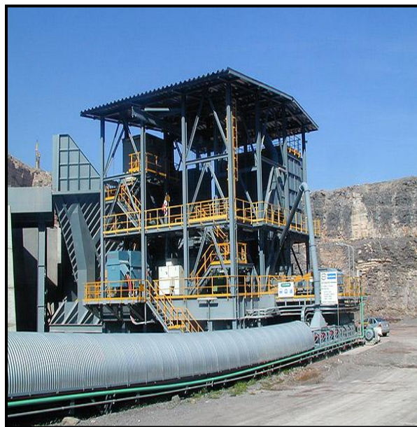
Figura 1.12 Instalación Estacionaria de Trituración Primaria Almacenamiento y Pre-homogenización
