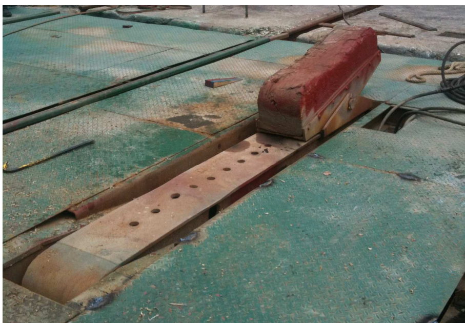
Figura N°27: Brazos Hidráulicos instalados.
