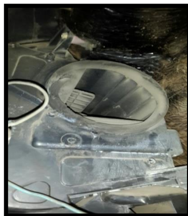
Fig. 6. ACOPLA DEL EVAPORADOR CON EL COMPARTIDOR DE VENTILACION. FUENTE AUTOR.
