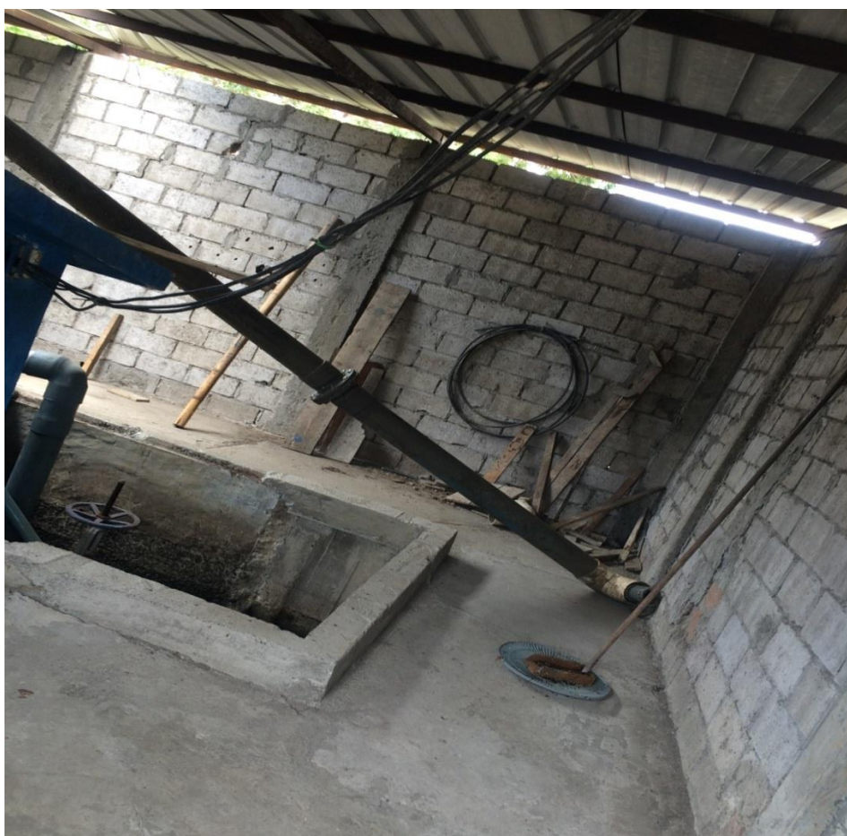
Fotografía 2. Estación de bombeo parroquia Panorama, cantón Duran.
