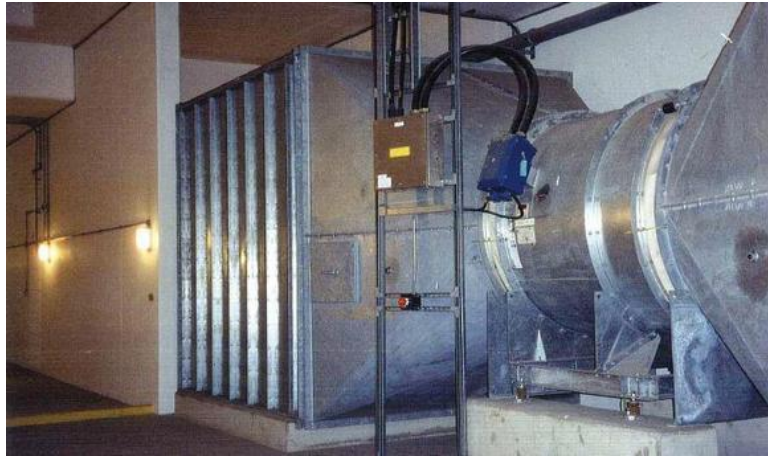
FIGURA 3.18. VENTILADOR ACOPLADO A UN ATENUADOR RECTANGULAR
