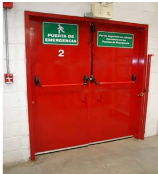
Figura 3.9 Puerta de Emergencia
