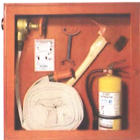
FIGURA 2.4 GABINETE CONTRA INCENDIOS[5]
