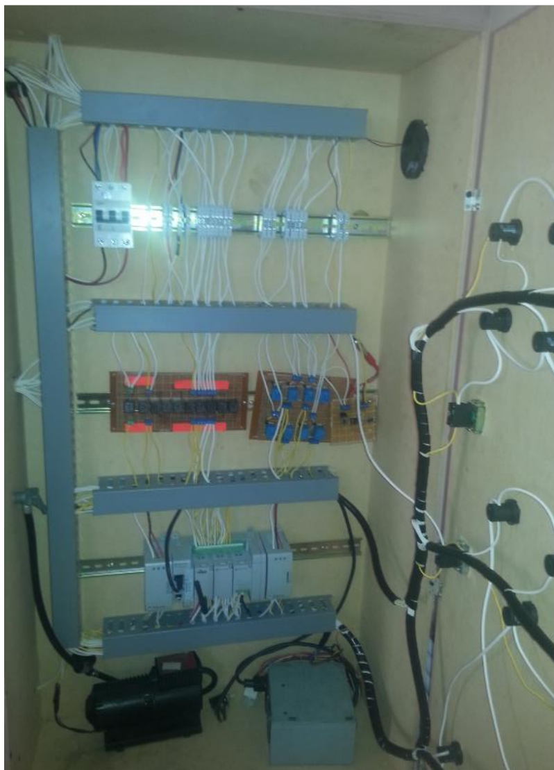
Figura 4.7 Conexiones del panel de control.
