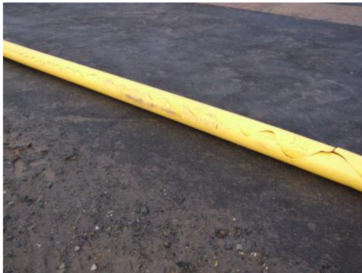
Figura 27. Forma ondulada por falla RCP. Tubo de Polietileno para transporte de gas.
