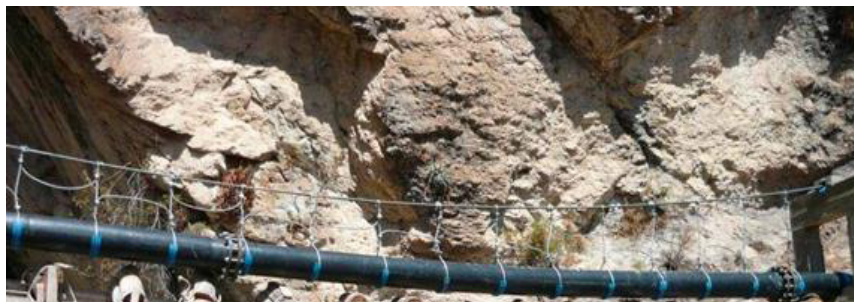
Figura 32. Ilustración tubería HDPE en puente colgante
